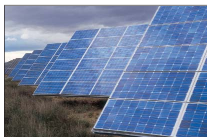
CENTRAL DE PLACAS SOLARES
